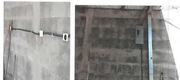
Foto 6: Instalación electrica en la galera de taller
